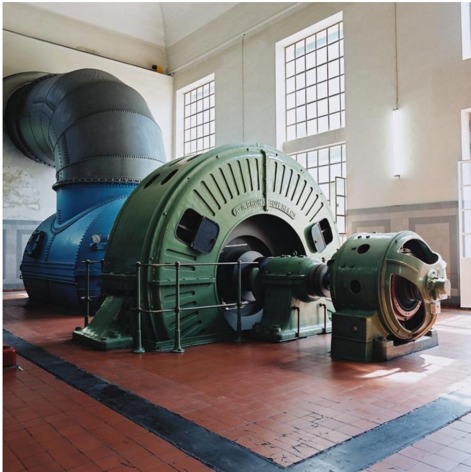
Turbine und Generator
