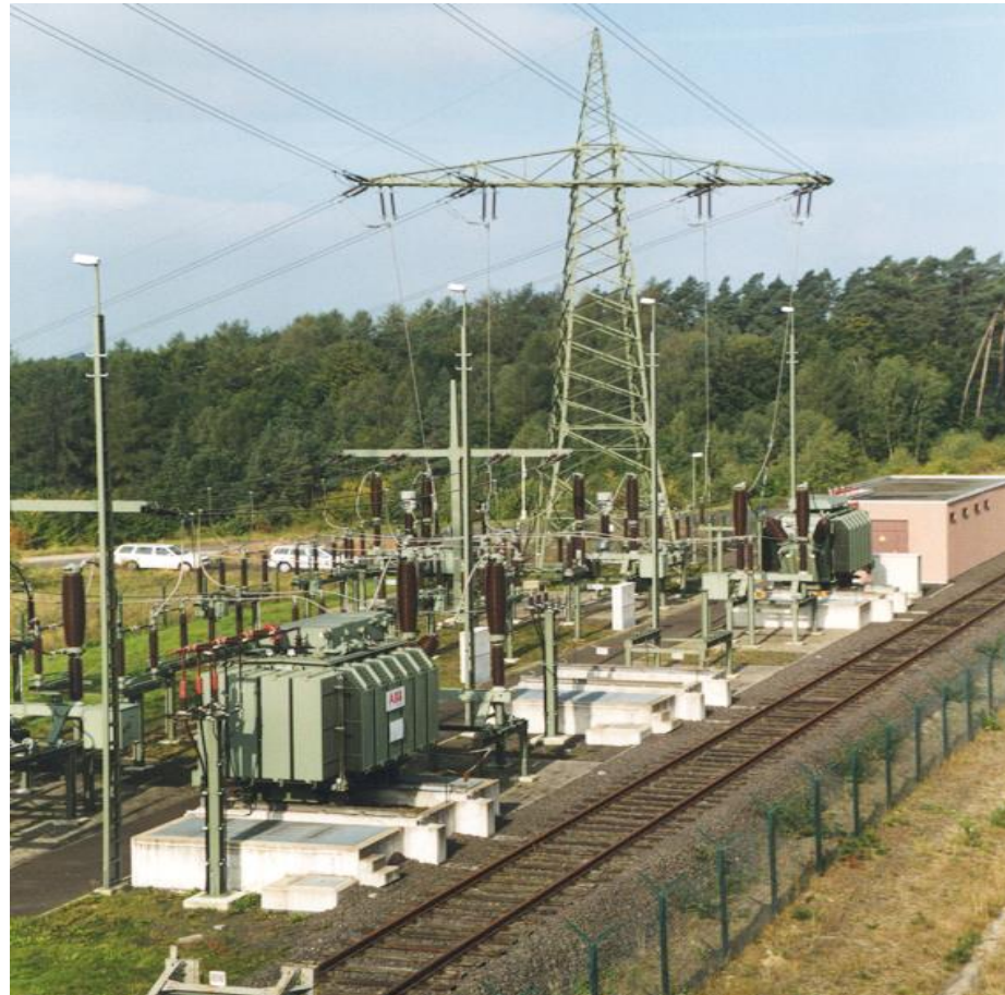
Unterwerk der DB Energie
