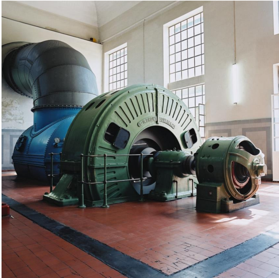
Turbine und Generator
