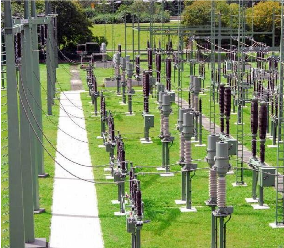
Umformerwerk 110kV Schaltanlage
